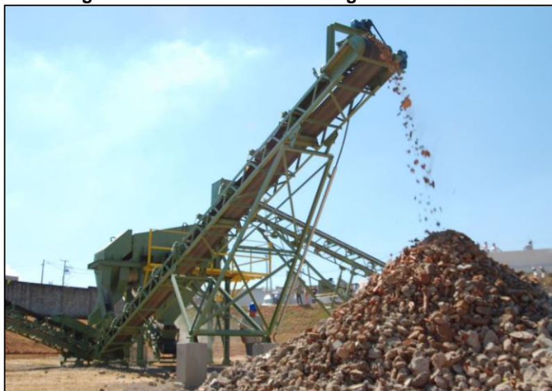
Figura 35 – Usina fixa de reciclagem de entulhos.
